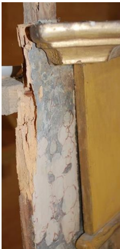
Slika 85. Detalj oštećenja drvenog nosača u zoni atike oltara Sv. Križa
