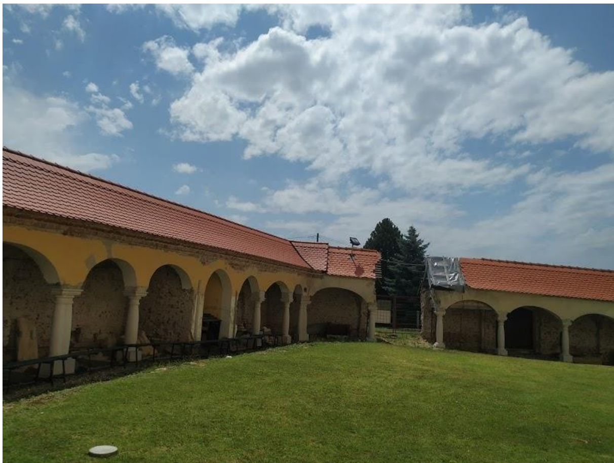
Slika 72. Oštećeni dio cinktora čiji su radovi još uvijek u tijeku (snimljeno 2021.)
