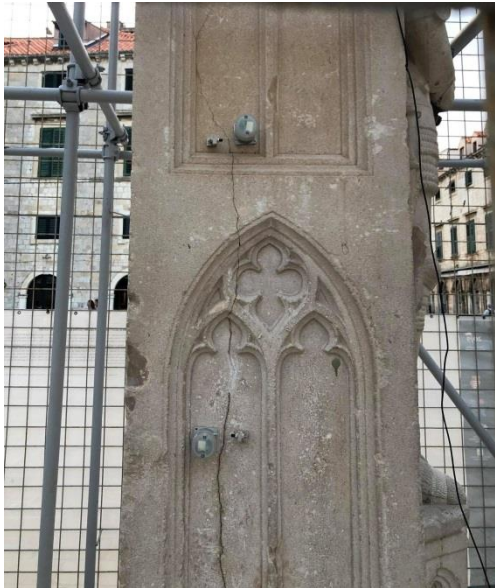
Slika 46. Vertikalna pukotina na istočnoj strani stupa
