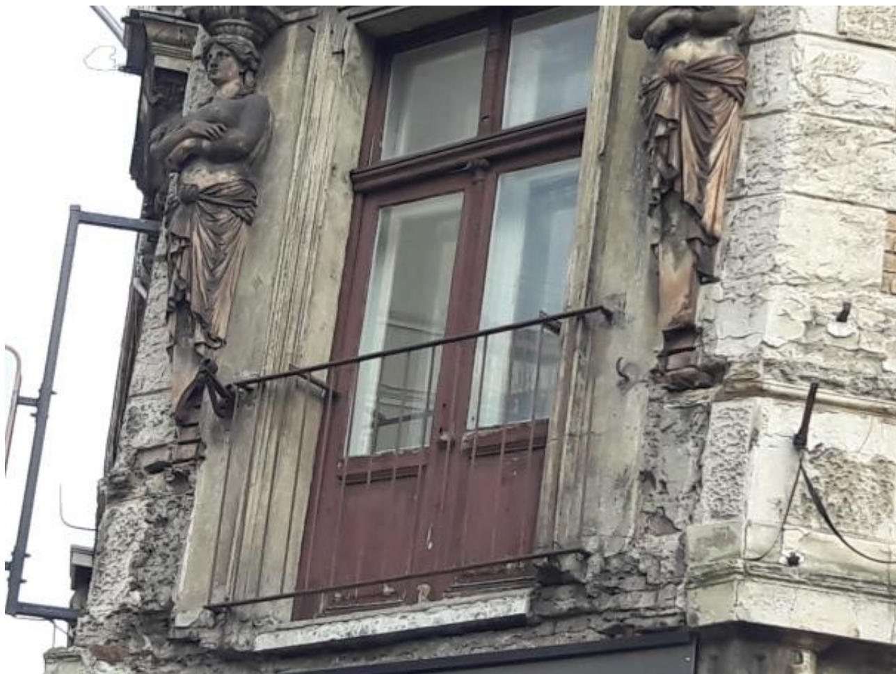
Slika 40. Sjeverno ugaono pročelje: oštećenja obloge zida i dekorativnih elemenata
