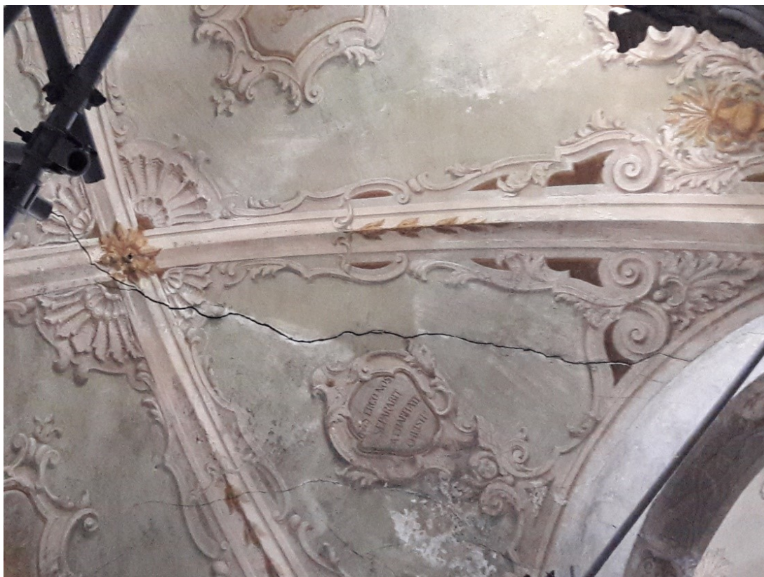
Slika 26. Pukotine na svodu sjevernog broda
