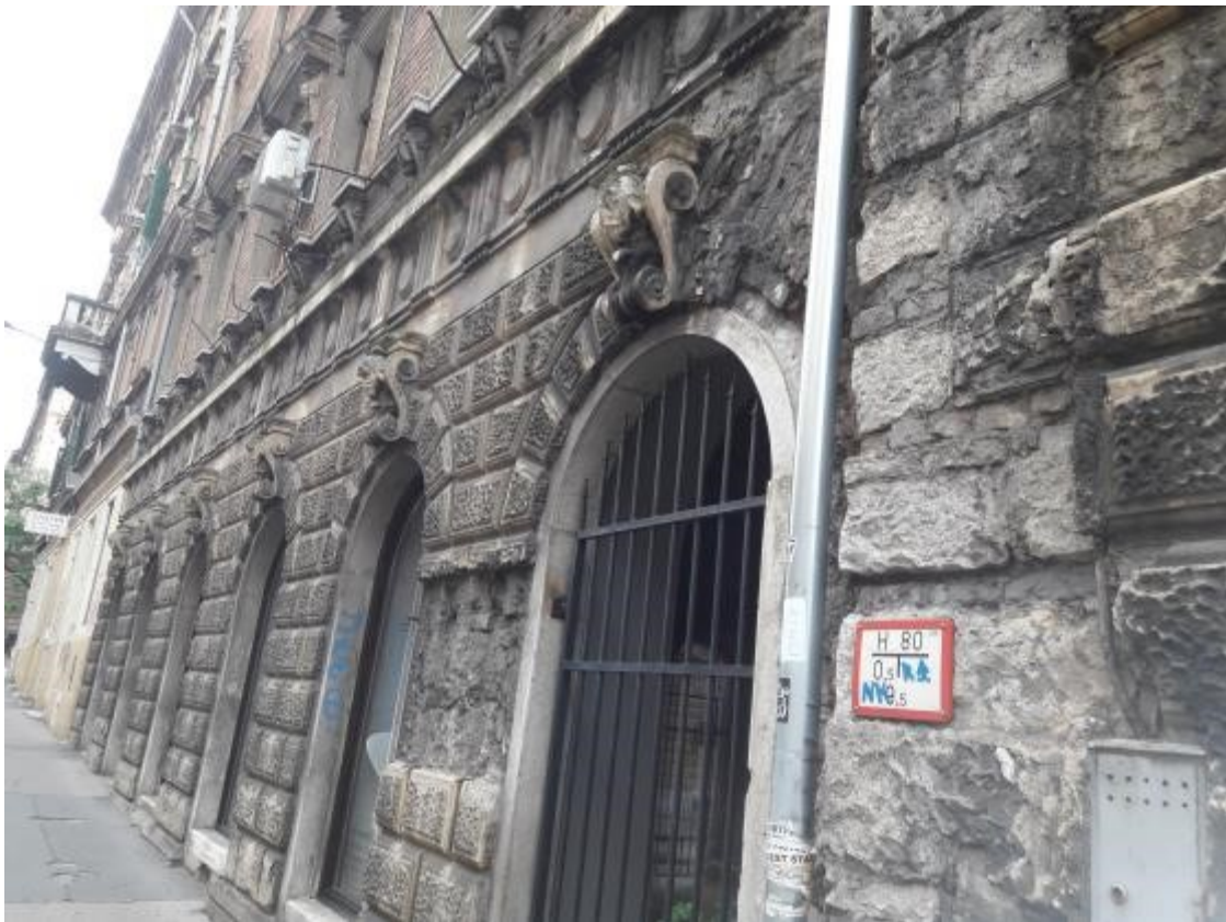
Slika 39. Donja zona sjevernog pročelja: mehanička oštećenja, oštećenja nastala djelovanjem vlage, crne kore
