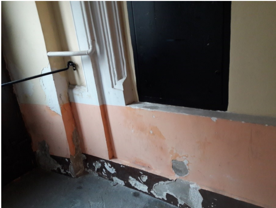
Slika 37. Djelovanje kapilarne vlage u ulaznom hodniku: donja zona zida
