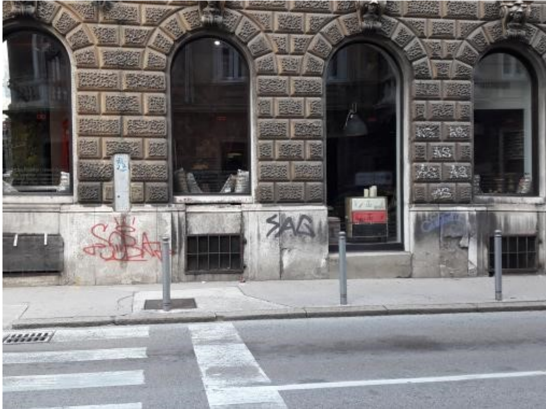
Slika 41. Južno pročelje: crne kore, grafiti i oštećenja zidnog obloga prouzročena vlagom
