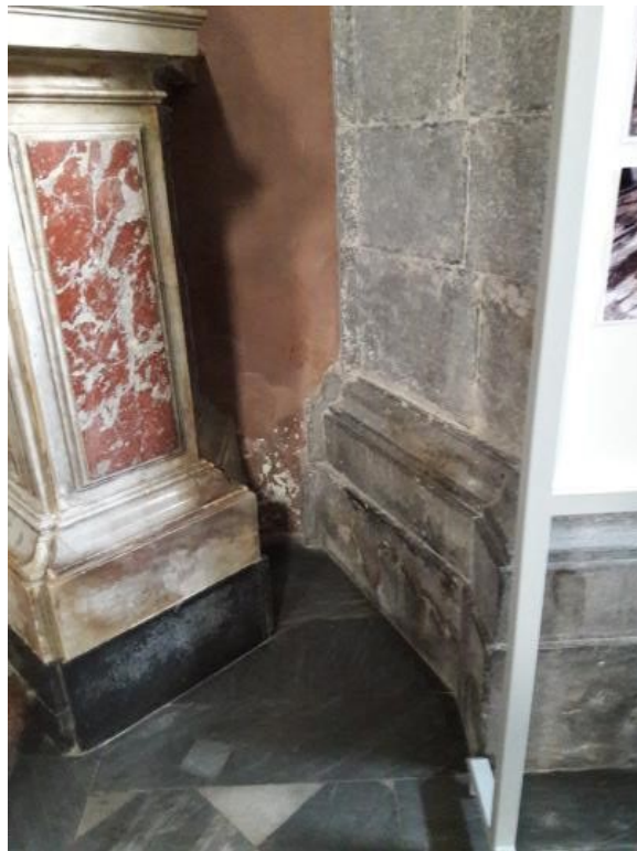
Slika 32. Oštećenja nastala djelovanjem kapilarne vlage u donjoj zoni zida južnog broda
