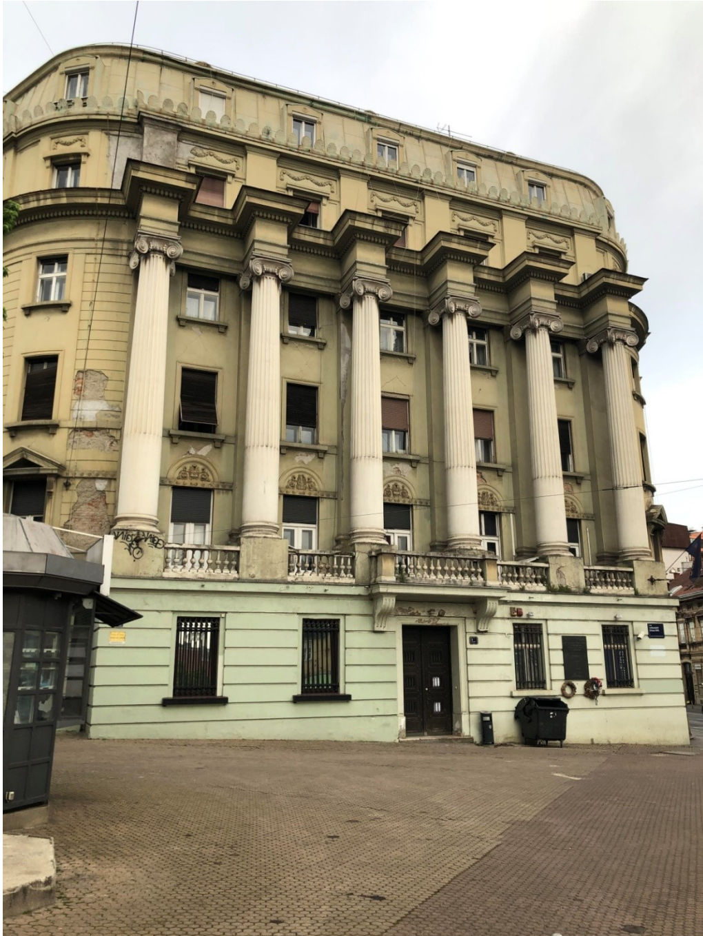
Slika 40. Stanje zapadnog pročelja Slavenske banke nakon potresa 22. ožujka 2020.
