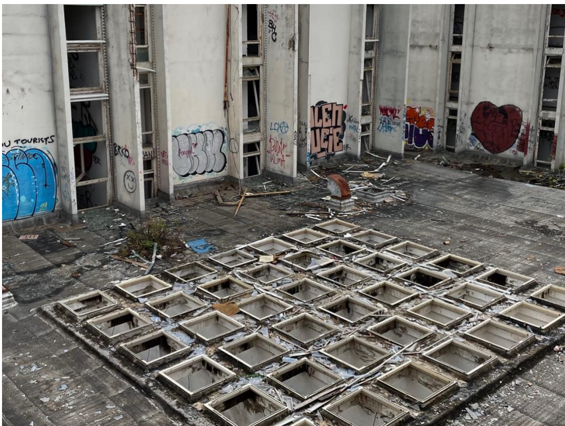
Sl. 16. Pogled iz hodnika prema razbijenim krovnim prozorima središnjeg dijela
