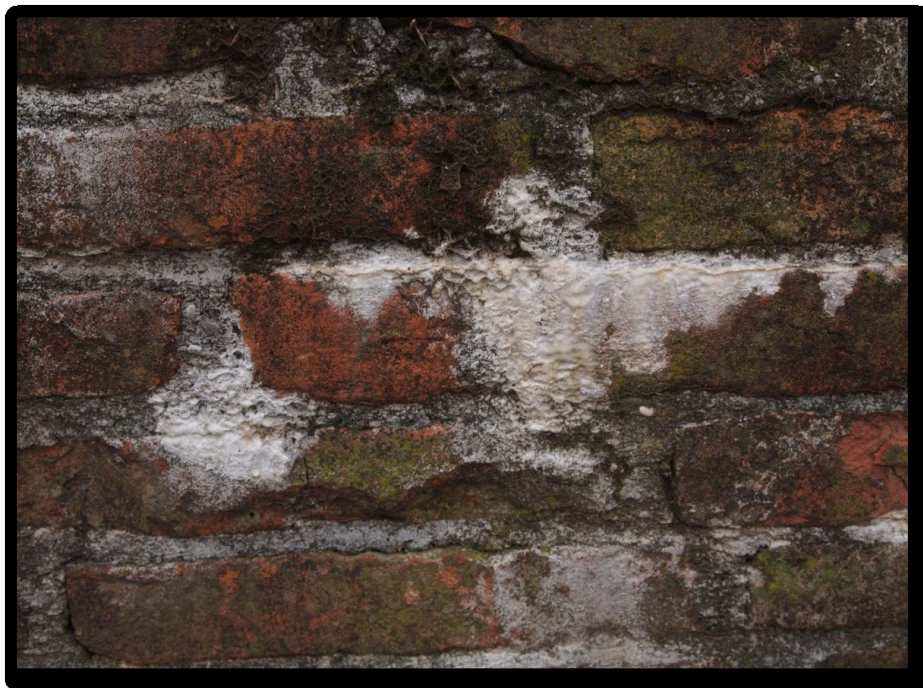
25 – detalj vanjske strane južnog dijela zidina, bijele staklaste nakupine; stanje u ožujku 2024. (snimio: F. Jajčinović)
