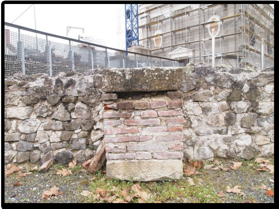
16 – Kontrafor s vanjske strane SZ zida žitnice; stanje u ožujku 2024. (snimio: F. Jajčinović)
