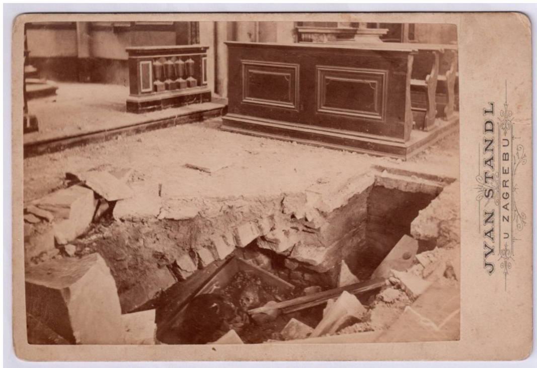
Slika 8. Potres u Zagrebu 1880. - oštećenje u katedrali
