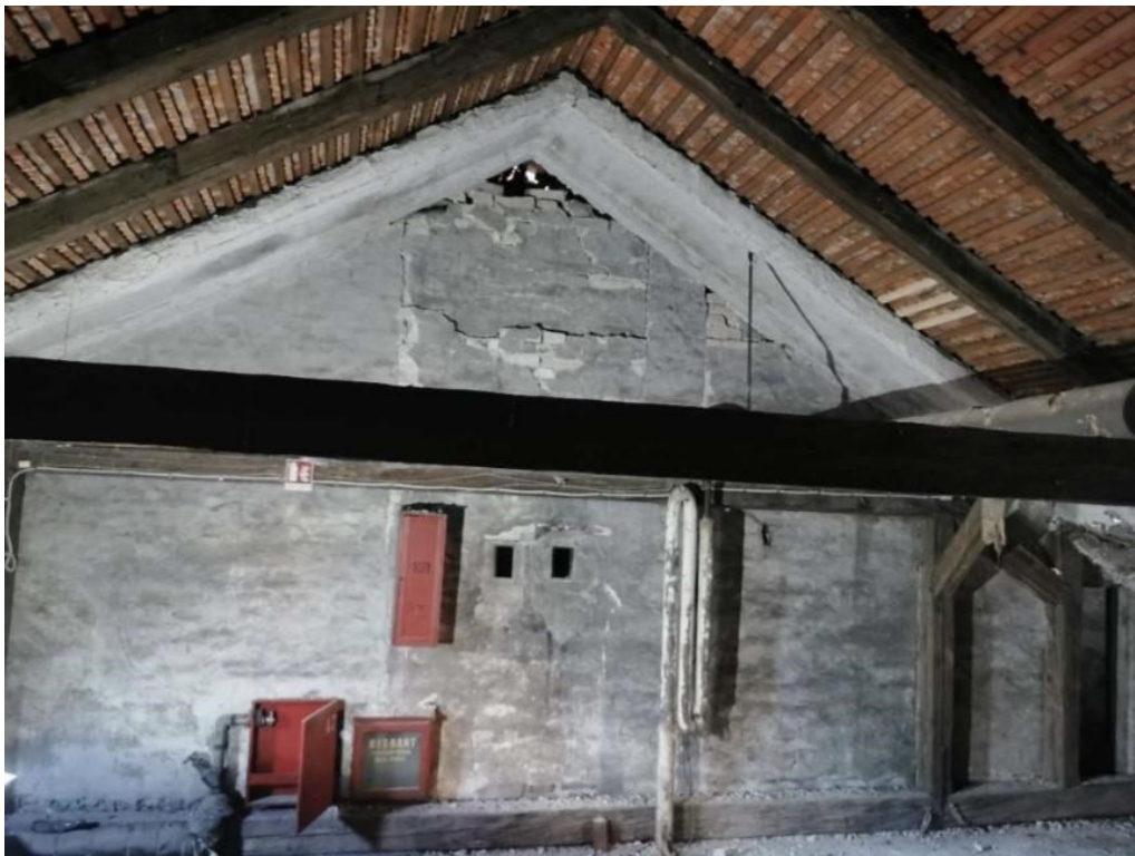
Slika 37.: Prikaz oštećenja vrha zabatnog zida u potkrovlju
