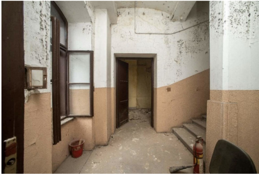
Slika 38.: Prikaz prisutnosti vlage na zidovima sjevernog stubišta
