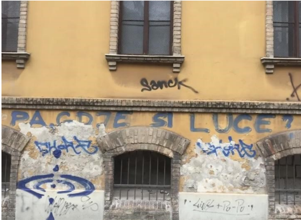
Slika 40.: Oštećenja na uličnom pročelju
