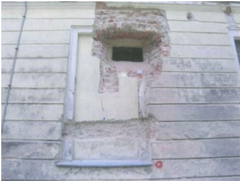
Slika 11: Sonda na zapadnom krilu sjevernog pročelja, otkriveni zazidani prozorski okvir
