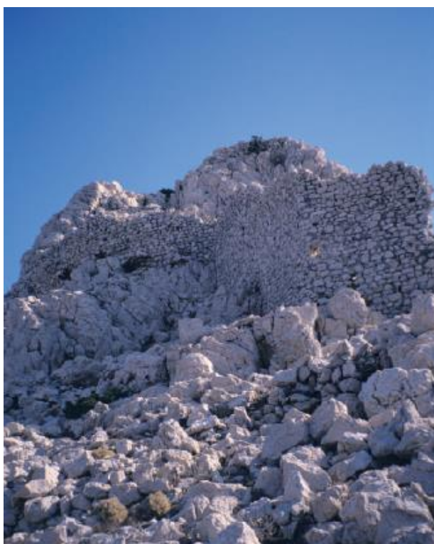
Slika 17. Ostaci zidova utvrde Fotografija: Emil Hilje, Spomenici povijenog graditeljstva na otoku Pagu, str. 124.
