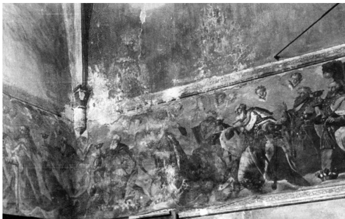
Slika 7 Lepoglava, župna crkva, zidni oslik kora crkve oštećen zbog vlage, Tihomil Stahuljak, 1946.
