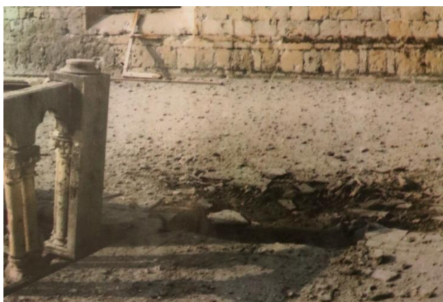
Slika 26. Teško oštećenje terase i ograde
