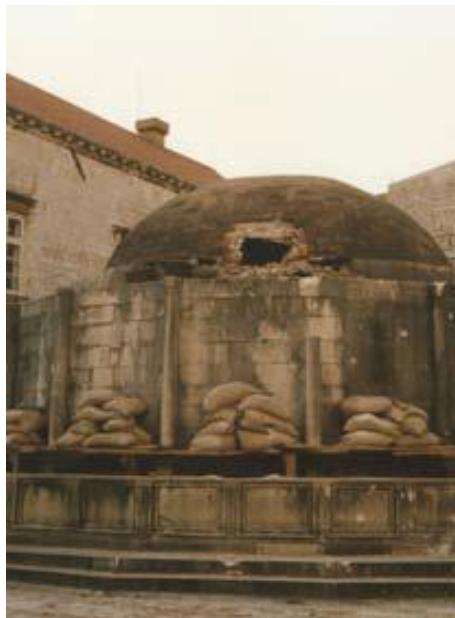
Slika 46. Oštećena Velika Onofrijeva fontana
