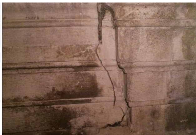
Slika 39. Pukotine i oštećenja kamenog zida
