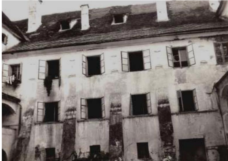
Slika 22. Dvorišno pročelje sjeveroistočnog krila, zazidane arkade umjesto kojih su probijeni novi prozorski otvori, 1962., fototeka Konzervatorskog odjela
