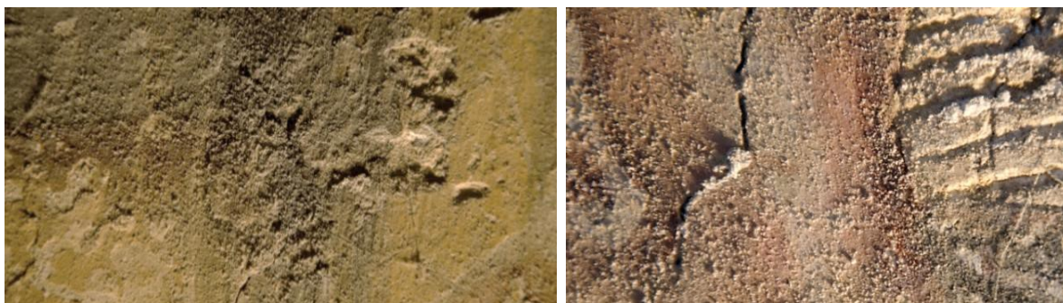
Slika 29 i 30: primjer oštećenja uzrokovana djelovanjem soli
