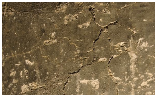
Slika 22: primjer pukotina na zidnom osliku
