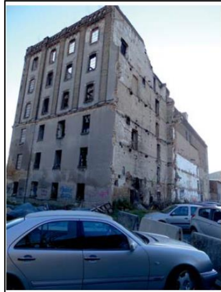
Sl. 36. Sjeverni zid transmisije, stanje nakon rušenja zgrade mlina
