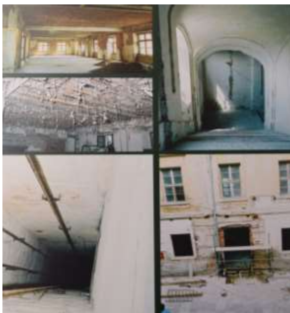
Slika 61. Glavna zgrada, dvorac Batthyány, zatečeno stanje dvorca 1991. godine pokazivalo je visok stupanj devastacije
