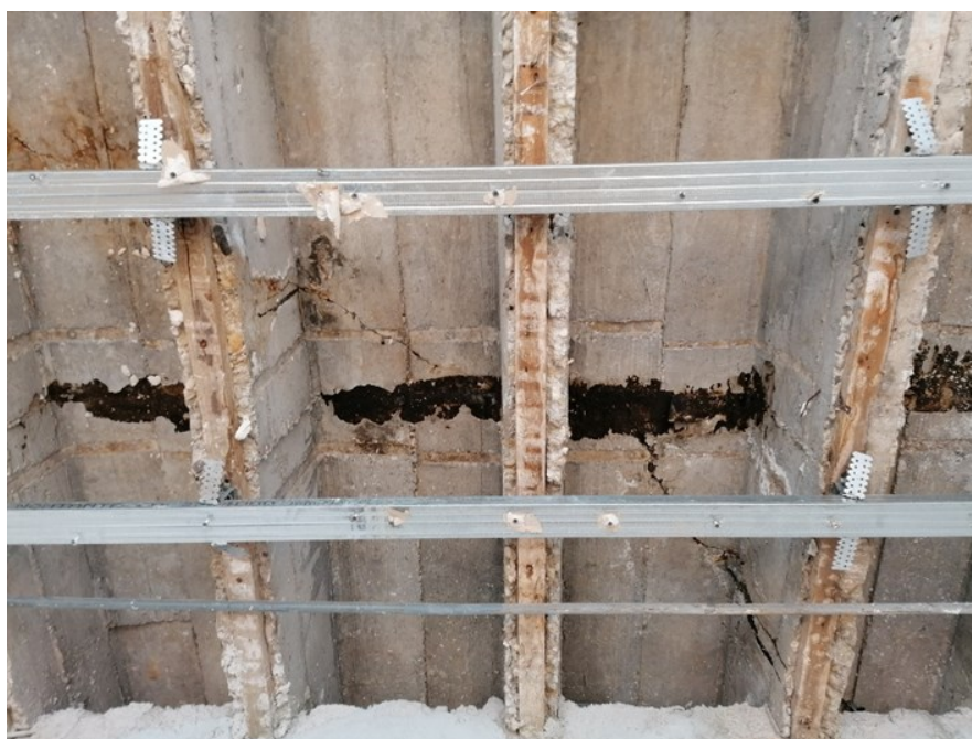
Slika 16. Pukotina na stropnoj konstrukciji, stanje u veljači 2022.
