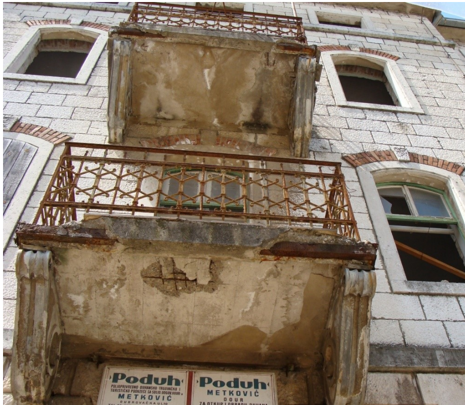
sl. 99. Stanje dijela istočnog pročelja zgrade uprave i stanovanja duhanske stanice u Metkoviću, danas Prirodoslovnog muzeja i Gradske knjižnice, fotografirano malo prije početka obnove zgrade koja je trajala od 2008. do 2015. godine. Vidljivi su derutni balkoni, kao i oštećeni okviri i stakla prozora
