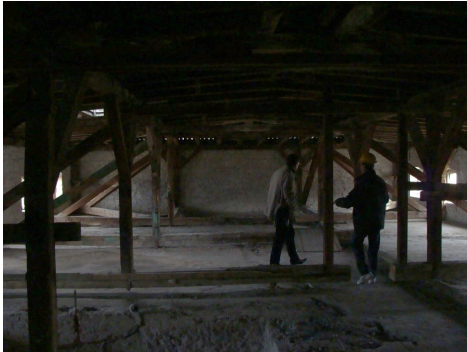
sl. 103. Izvorno mračno potkrovlje zgrade uprave i stanovanja duhanske stanice u Metkoviću, danas Prirodoslovnog muzeja i Gradske knjižnice, fotografirano prije ili na početku obnove zgrade koja je trajala od 2008. do 2015. godine. Vidljiva je i unutarnja drvena krovna konstrukcija, koja je kasnije zamijenjena armiranobetonskom
