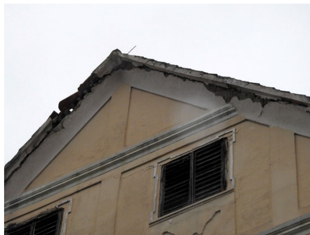
Slika 62 – Oštećeni potkrovni dijelovi žbukanih površina pročelja nakon potresa 28. i 29. prosinca 2020. godine, dvorac Lužnica
