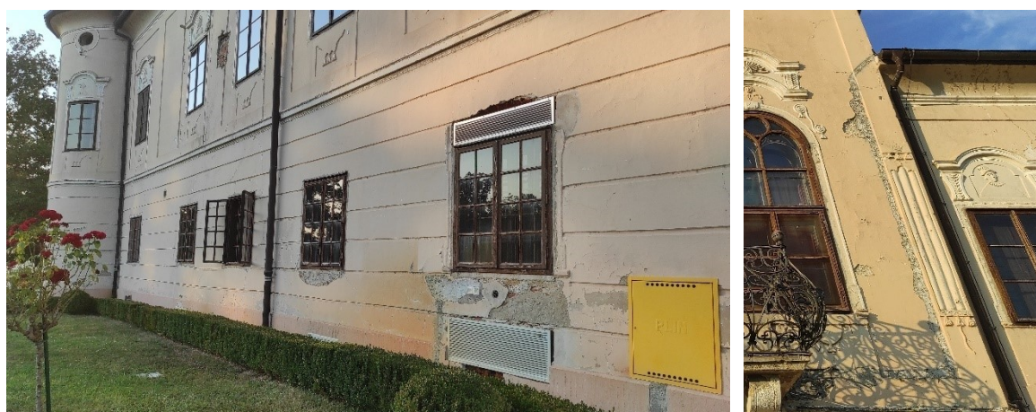
Slika 65 – Oštećenja uzrokovana ugradnjom ventilacije i prolaskom instalacija, južno pročelje, dvorac Lužnica
