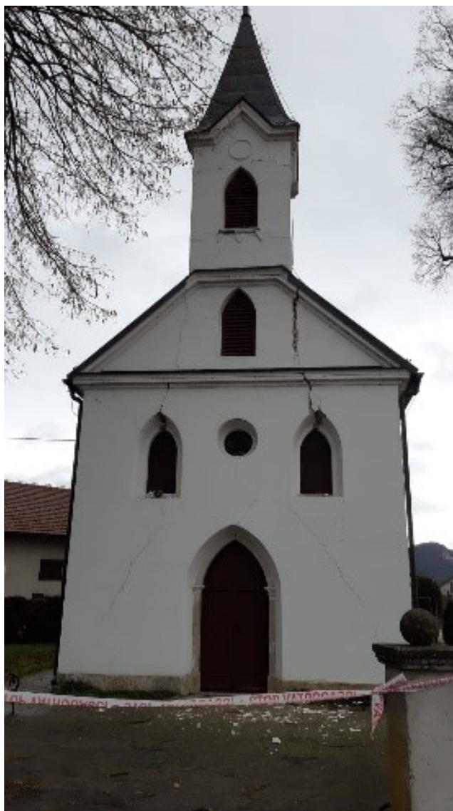
Slika 14 – Župna crkva svetog Petra, Zaprešić, 1869., vidljiva oštećenja nastala u potresu 29. prosinca 2020.
