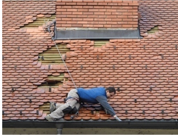
Slika 61 – Oštećenja krovišta nakon potresa 28. i 29. prosinca 2020. godine, dvorac Lužnica
