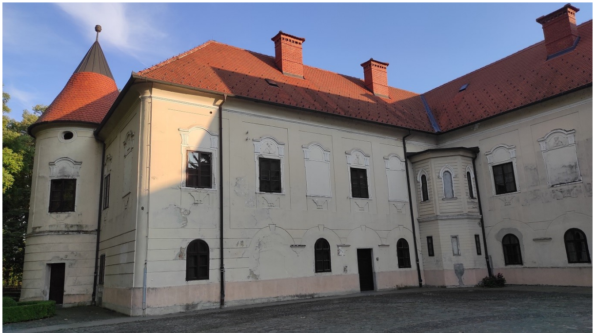
Slika 36 – Zazidani arkadni trijemovi u prizemlju i umetnuti prozorski otvori, zazidani prozorski otvori na prvom katu, vidljiv izostanak razdjelnog vijenca između prizemlja i prvog kata (na cilindričnoj ugaonoj kuli još postoji), neogotička poligonalna kulica, sjeverno dvorišno pročelje, dvorac Lužnica
