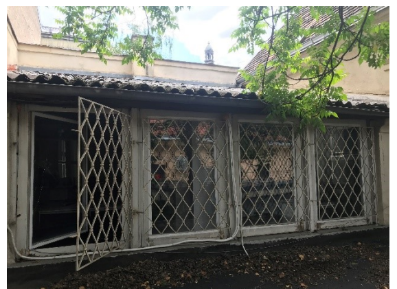
Sl. 80. Pogled na ostakljenu 1. kat sjevernog pročelja, odnosno nekadašnju prostoriju koja je nosila funkciju fotografskog atelijera; fotografirano 31. svibnja 2021. (M. Šafarić)
