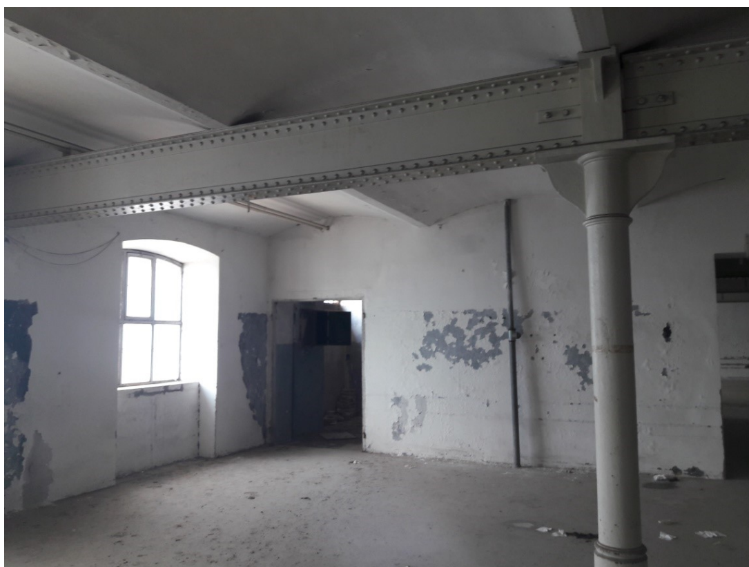
Slika 50. Zapuštena unutrašnjost skladišta
