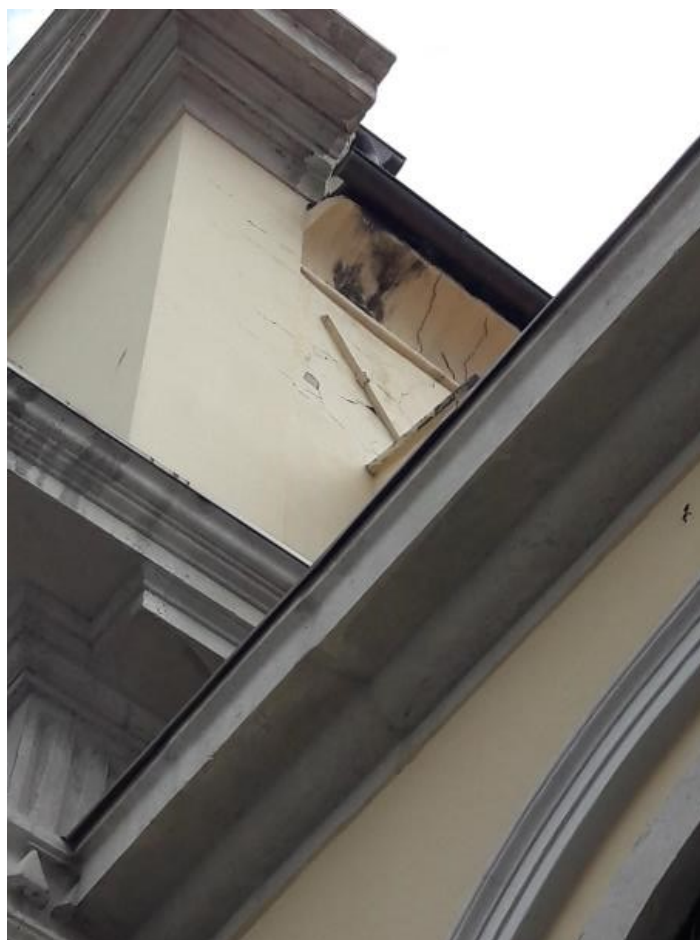
Slika 25. Podlijevanje vode zbog neadekvatnosti odvodnje oborinskih voda
