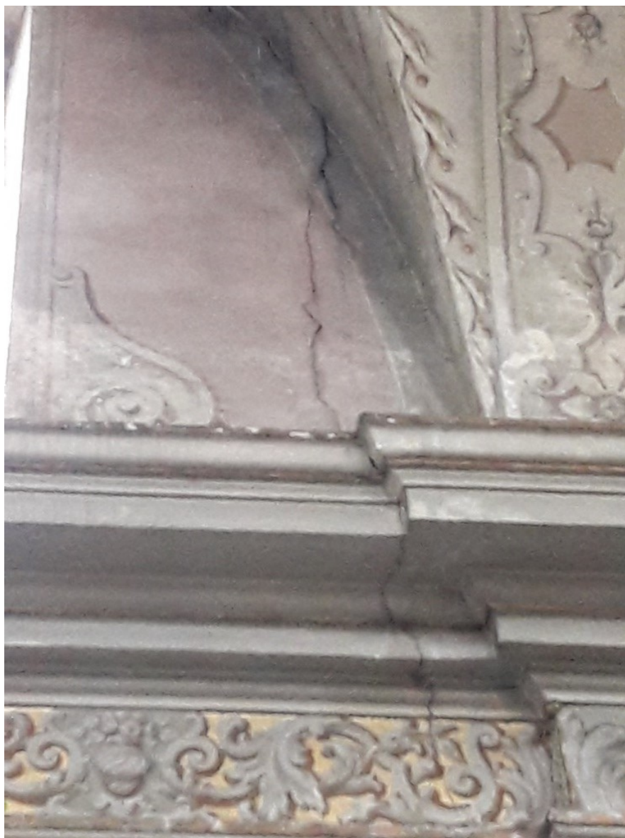
Slika 27. Pukotine na sjevernom zidu glavnog broda
