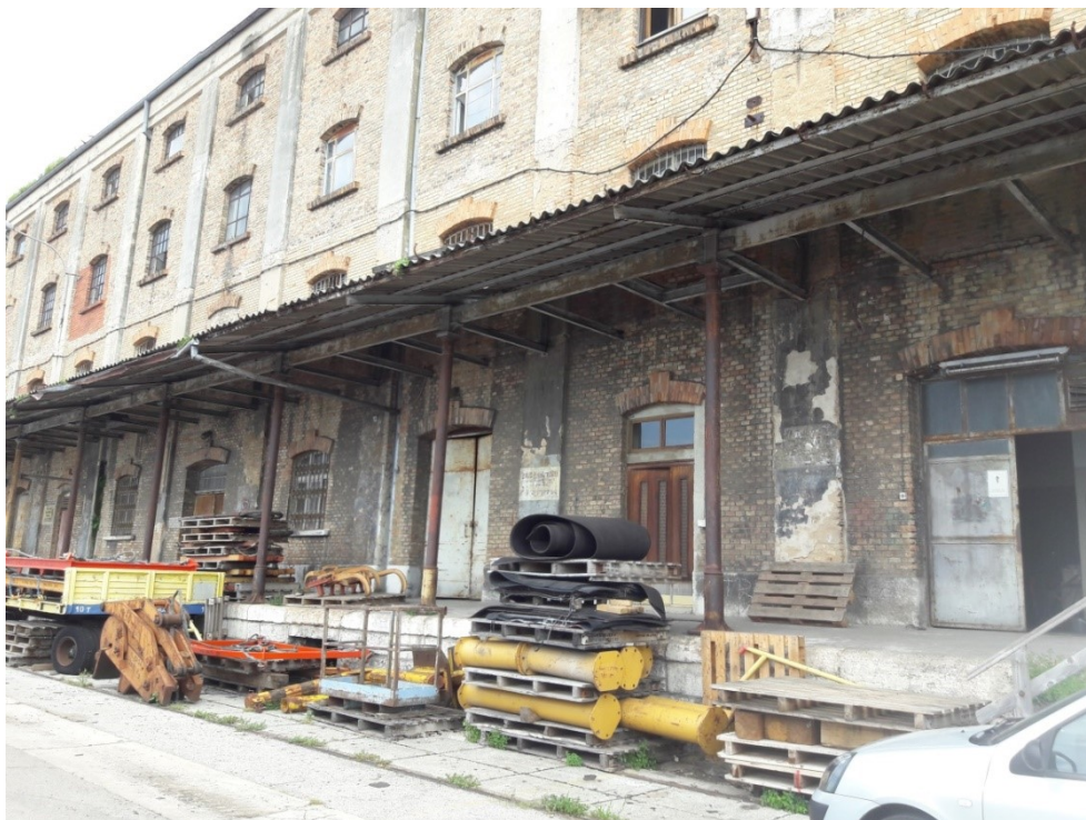
Slika 48. Dio južnog pročelja: crne kore, hrđa
