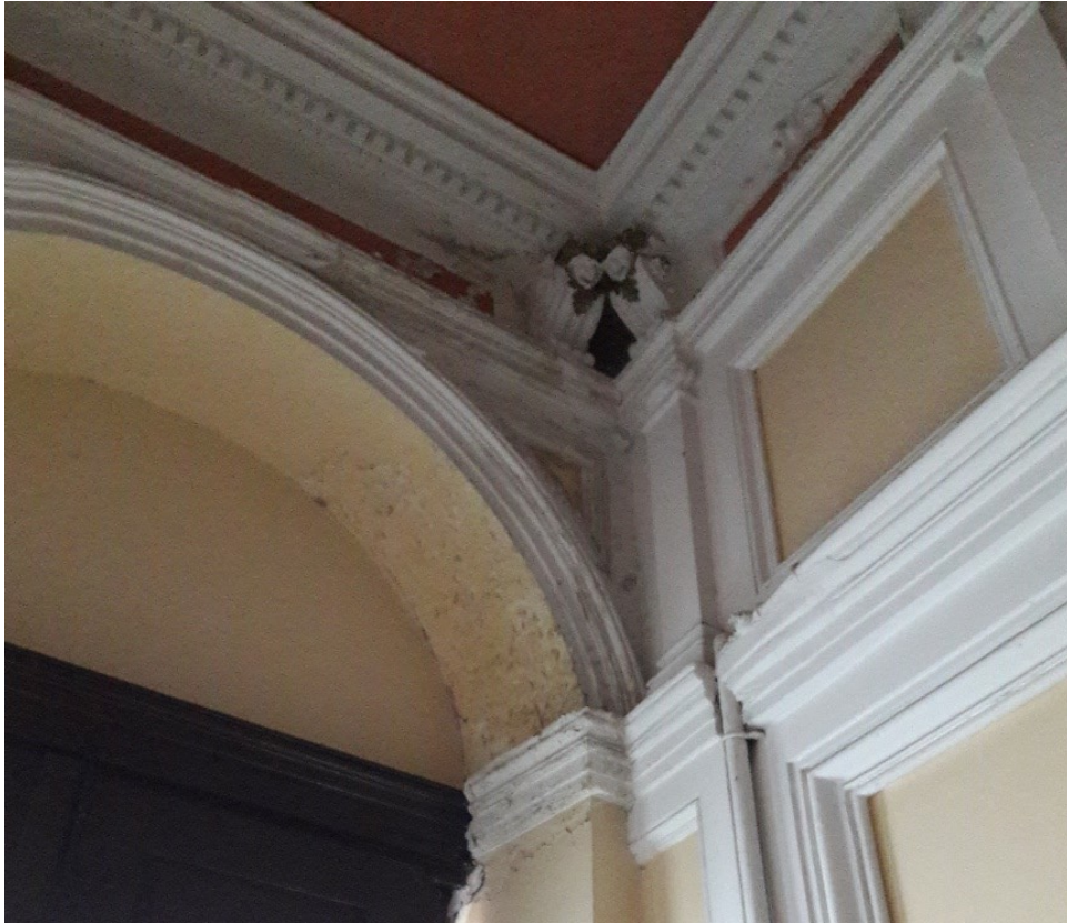
Slika 36. Djelovanje vlage u ulaznom hodniku: luk nad ulazom
