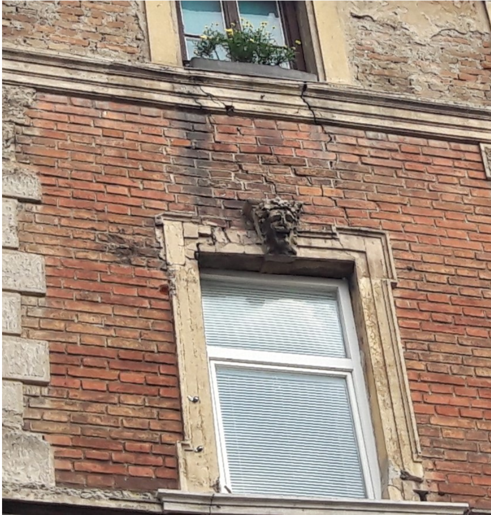
Slika 35. Pukotine i deformacija zida na zapadnom pročelju
