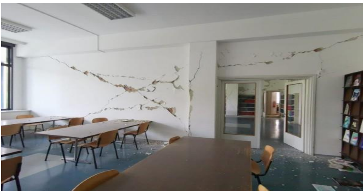
Slika 5. Oštećenje radi potresa – čitaonica SKM
