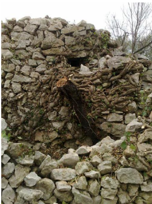
Slika 79: Pogled na Rašinov stan s istoka gdje je nakon truljenja korijenja kasnije nastupilo urušavanje – stanje nakon čišćenja bršljana
