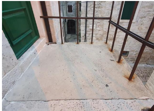
Slika 25: Detalj odmorišta jednokrakog kamenog stubišta – korozija ograde i naknadna intervencija betonom
