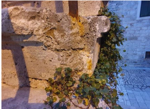
Slika 24: Detalj stubišta s odlomljenim dijelom i biološkim rastom
