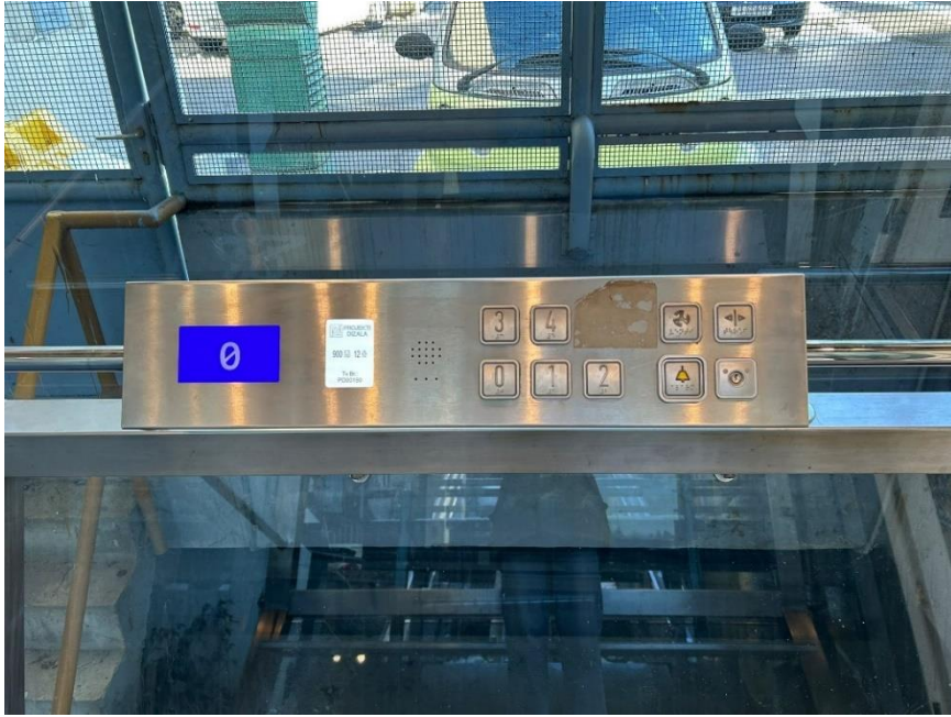
Sl. 24. Upravljačka ploča uspinjače (autorska fotografija, 2024)
